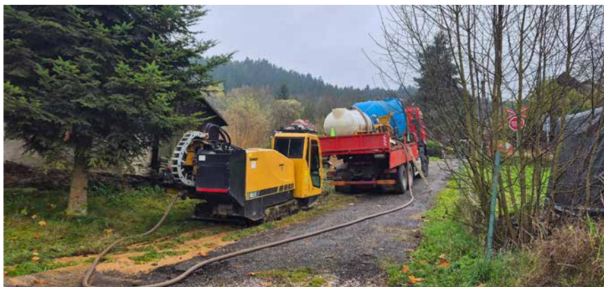
Na dvou místech vodovod kříží železniční trať, pro což existují dost přísné normy.
