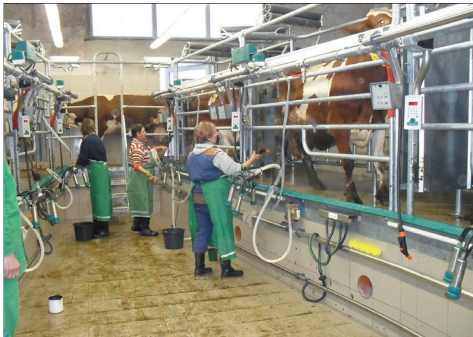
V původní přípravně krmiv byla vybudována čekárna pro dojnice a plně Auto Tandemová dojírna Westfalia 2 x 5, která splňuje stále rostoucí požadavky na hospodárnost v mléčných farmách.
